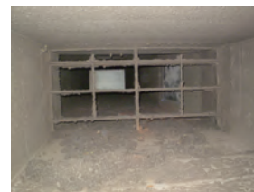
築15年のダクト
