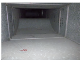
築3年のダクト
