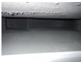
築8年のダクト
